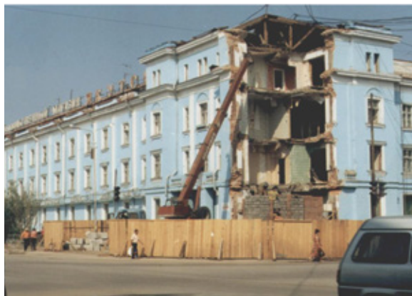
Мал. 2.8.11. Абвальванне вугла будынка. Цэнтр г. Якуцк (Расія).
